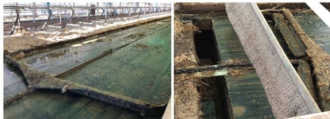
Abbildung 14: Außenklimastall mit stationärer Schieberentmischung, die Flüssigmist und Einstreureste mehrmals täglich aus dem Rinderstall entfernt (Bildquelle: F. Becker, INL GmbH)
